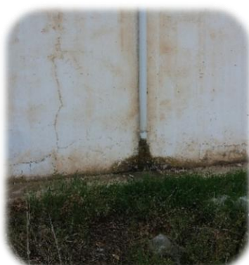
Photo 27 : Descentes d'eau pluviale déterorées
