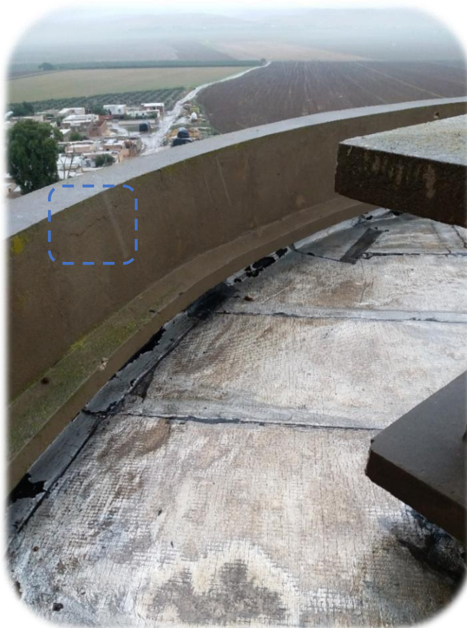
Photo 19 : Fissure suite à la corrosion d'armatures au niveau de l'acrotère
