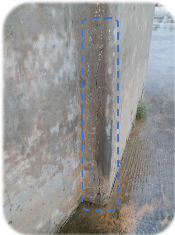
Photo 17 : éclatement du béton suite à la corrosion d'armature
