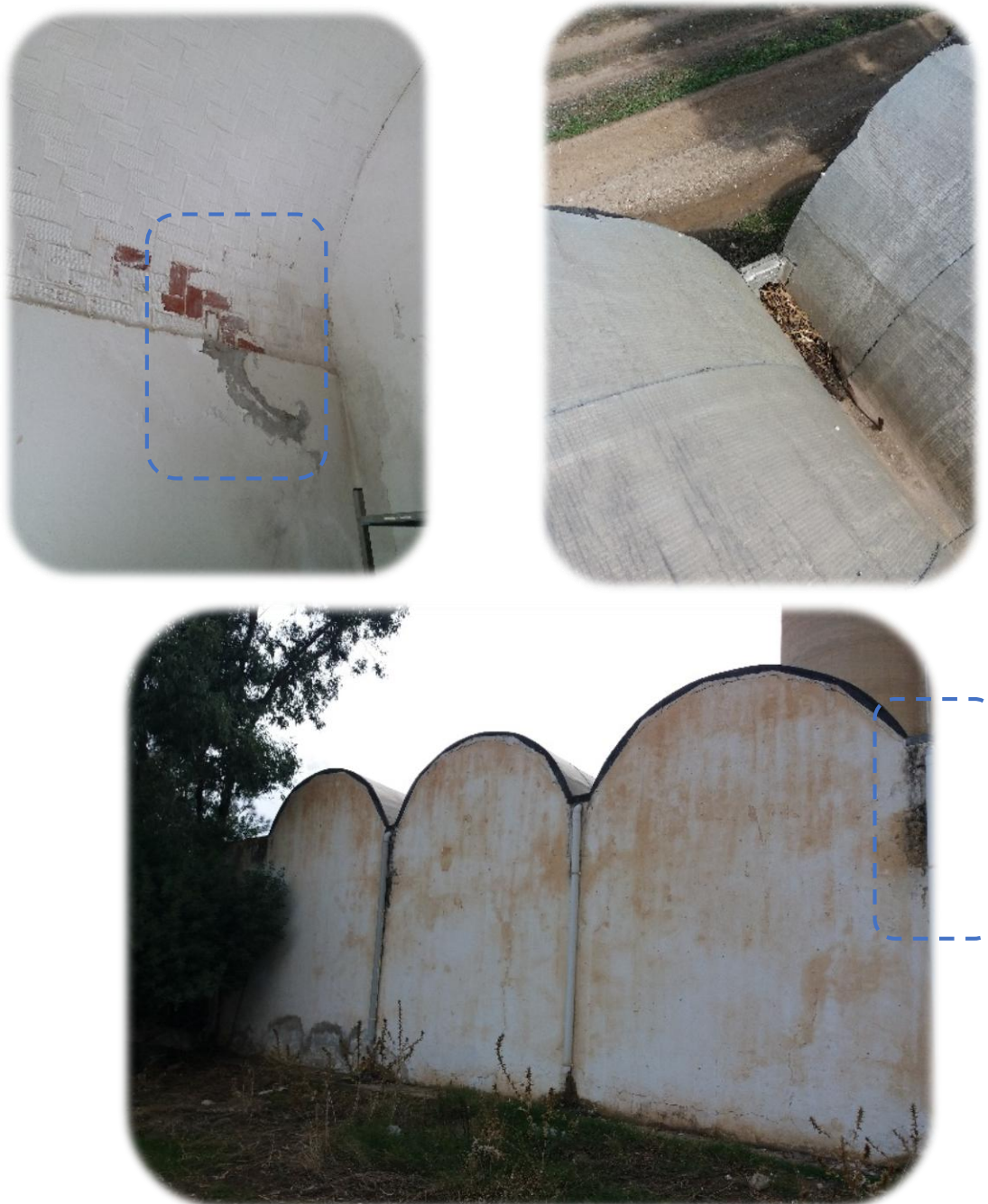
Photo 21 : Traces d'infiltration des eaux pluviales dans les voutes
