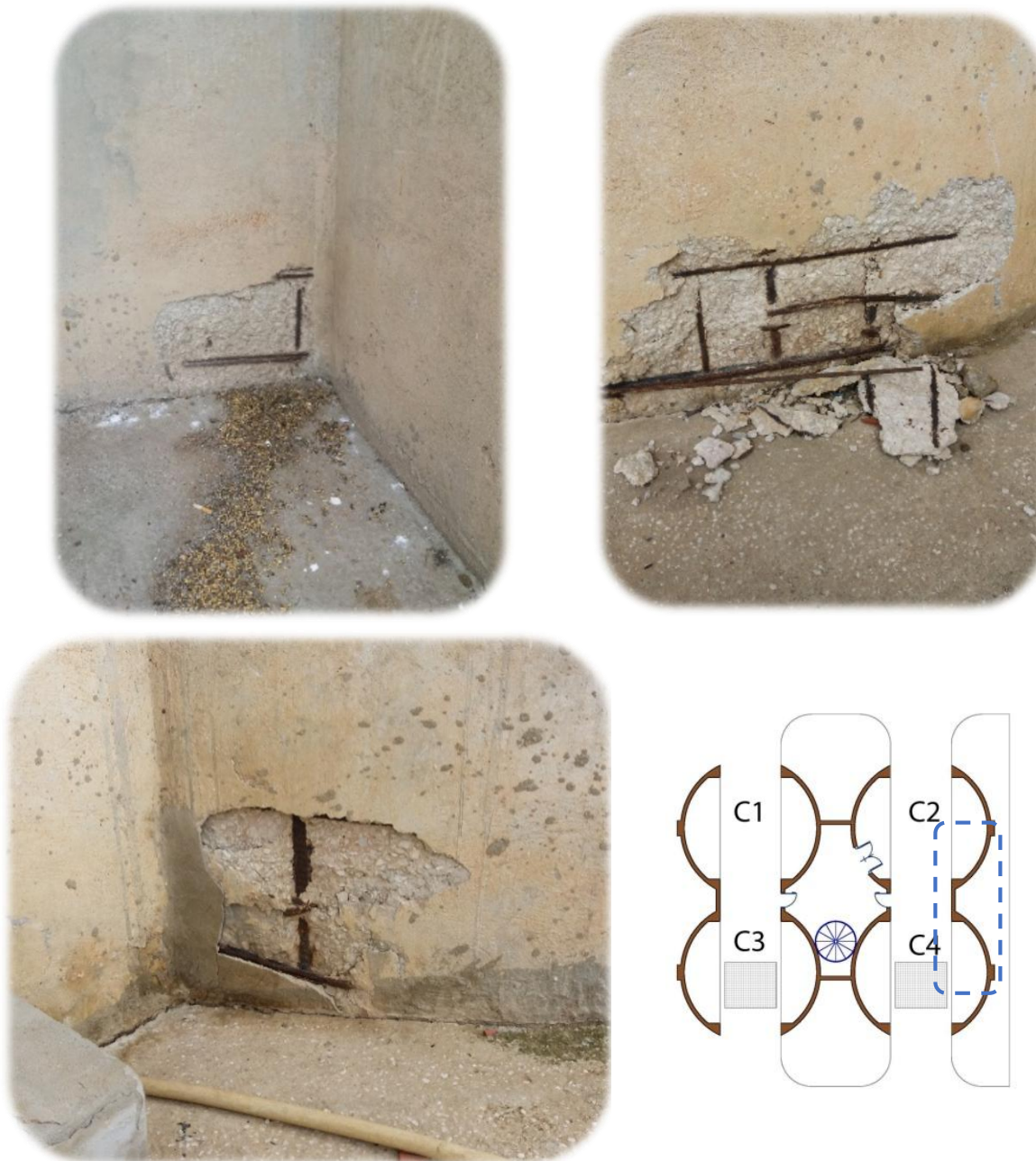
Photo 15 : éclatement du béton et corrosion d'armature
