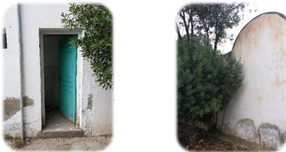
Photo 22 : Humidité dans les murs extérieurs
