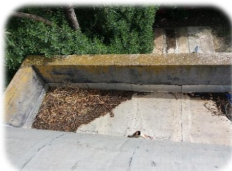
Photo 28 : Terrasse non entretenu
